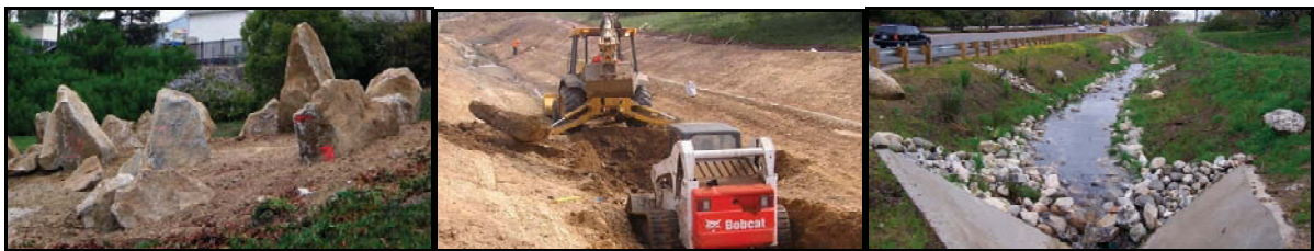
Newport Boulevard Bioswale
